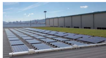
神戸技術センターの太陽光発電設備
