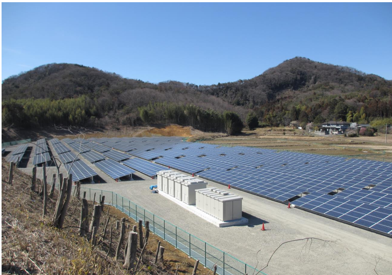
ミライト栃木小野寺太陽光発電所
