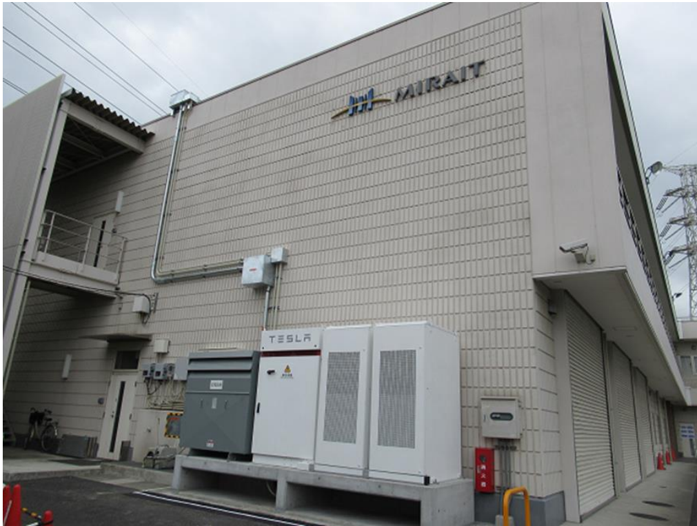
ミライト市川研修センターへの設置状況
