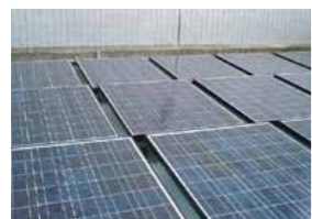
太陽光発電設備
