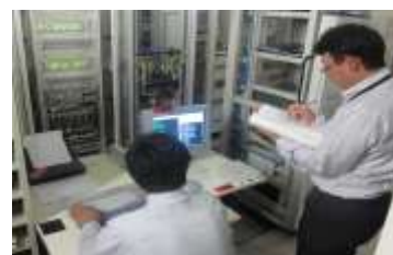
交換機プログラム更新作業
