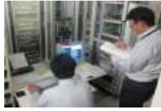
交換機プログラム更新作業
