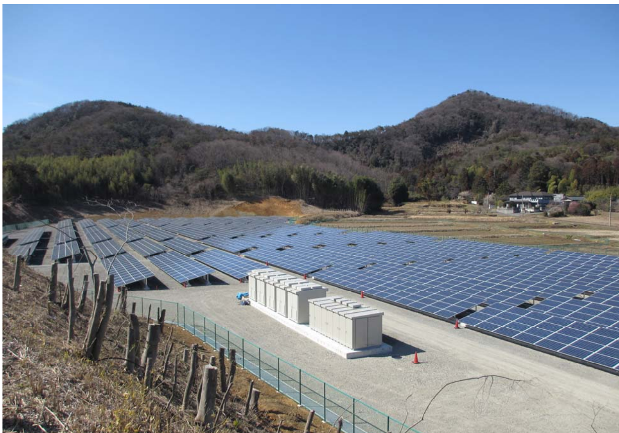
ミライト栃木小野寺太陽光発電所
