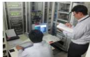
交換機プログラム更新作業
