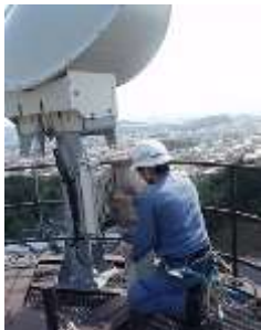
無線基地局保守点検
