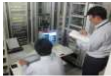
交換機プログラム更新作業
