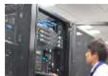
データセンタ保守
