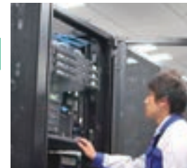
データセンター保守
