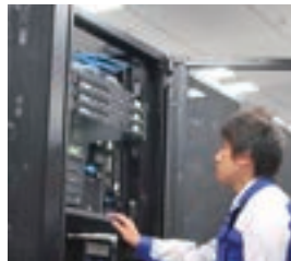
データセンター保守
