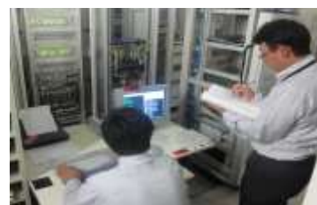
交換機プログラム更新作業
