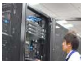
データセンタ保守
