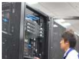
データセンタ保守
