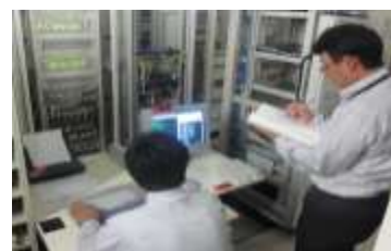
交換機プログラム更新作業
