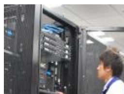
データセンタ保守
