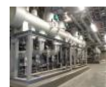
地下空調設備
