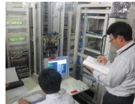
交換機プログラム更新作業
