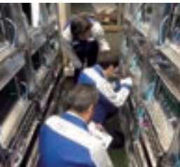
PBX・LAN工事
