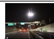
高速道路照明
