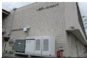
蓄電池システム
