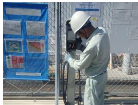
設置後の通信・動作確認
