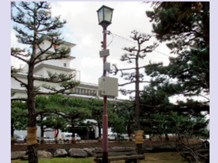
屋外 Wi-Fi 機器
