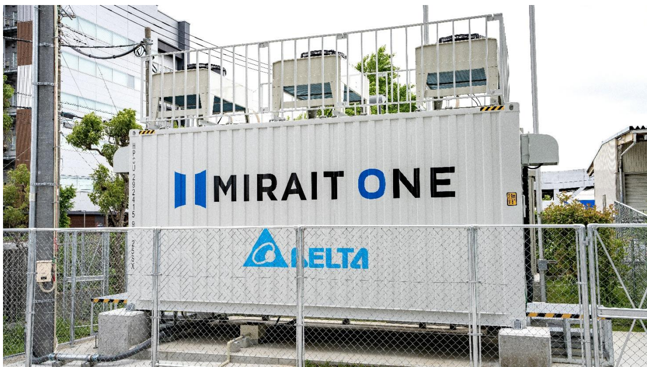
デルタ電子 LTA CDU 搭載の水冷コンテナ型データセンター
