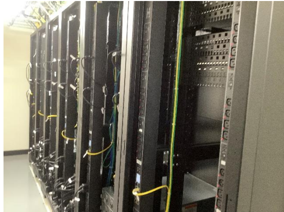
愛媛県内 GDC(遊休施設を活用した DC)
